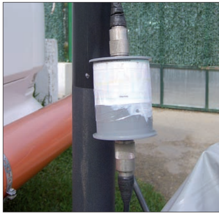
Bild 5: Die Mantelwellensperre ist in einem Gehäuse aus zwei Rohrkappen DN50 untergebracht.
