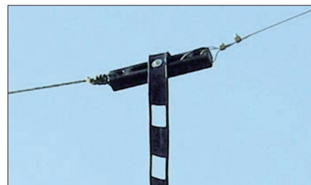
Bild 3: Isolator an der Einspeisung mit Abspannung links und Antennendraht rechts Fotos: DK7ZB
